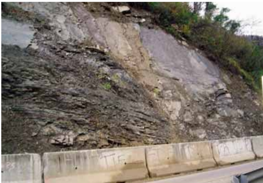
Il terreno franato sulla provinciale 177 ha lasciato scoperto il costone di roccia
